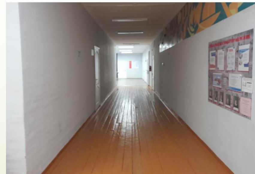
Коридор 2 этаж. ДО ремонта
